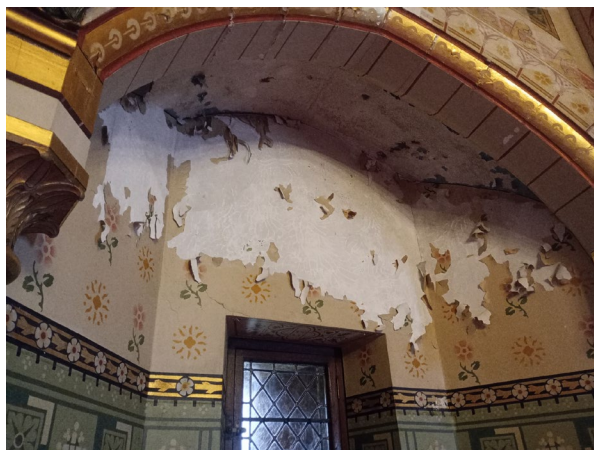
Schade door vocht
